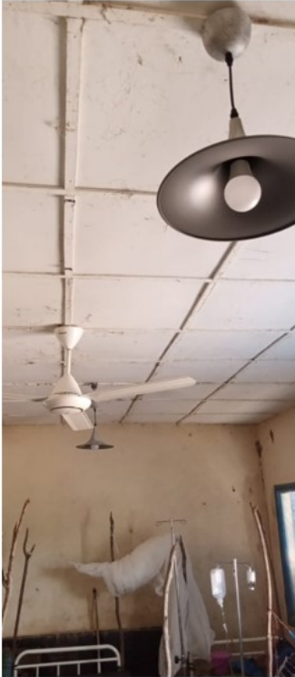
nouvel éclairage Led et brasseur d'air
